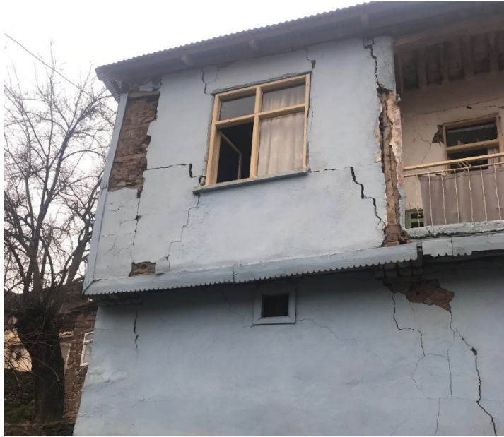
Şekil 5.5. Ahşap oturma çatılı bir yığma yapı hasarı
