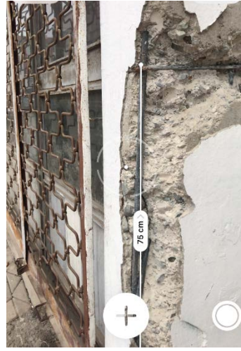
b) Sarılma bölgesinde etriye yok
