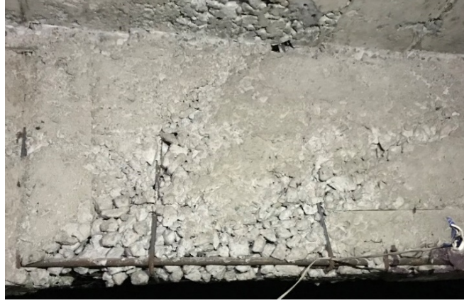
b) Kirişte iyi yerleşmemiş beton
