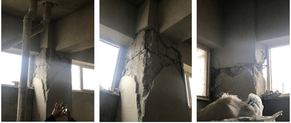
Şekil 4.10. Malatya Doğanyol küçük işletme (un fabrikası) kısa kolon hasarları
