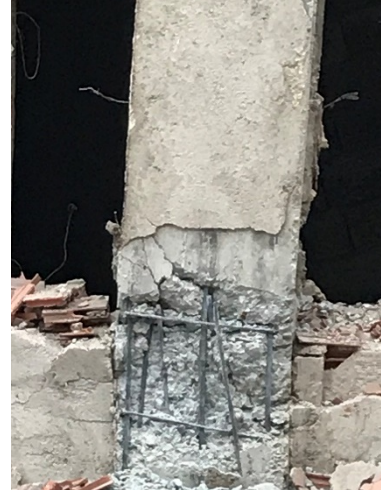
e) Birleşim bölgesi plastik mafsall oluşumu
