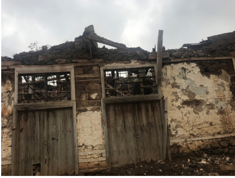
Şekil 5.4. Ağır toprak çatılı yığma yapı enkazı
