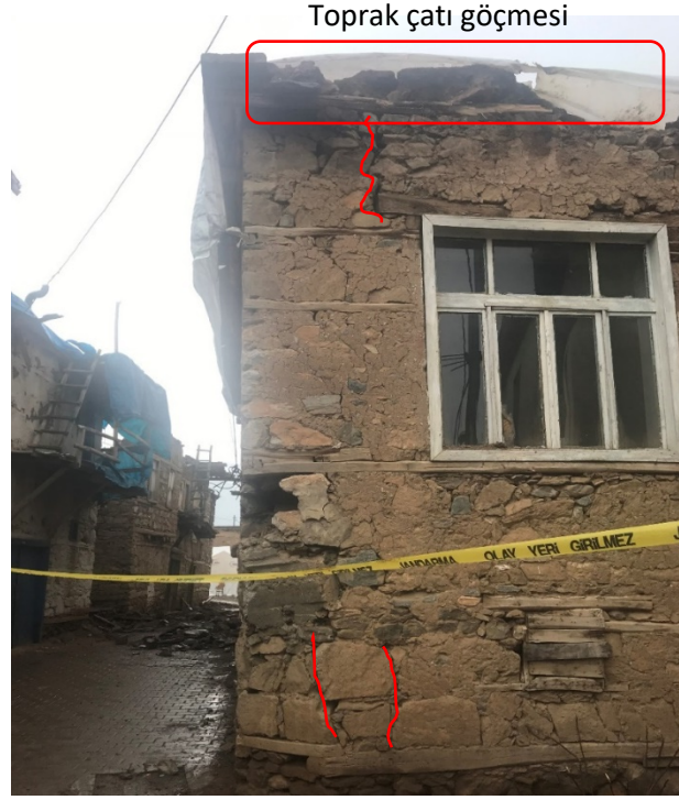
Şekil 5.2. Çatısı yıkılmış ve duvarları hasar görmüş taş yığma yapı örneği
