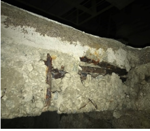
a) Kirişte donatı korozyonu
