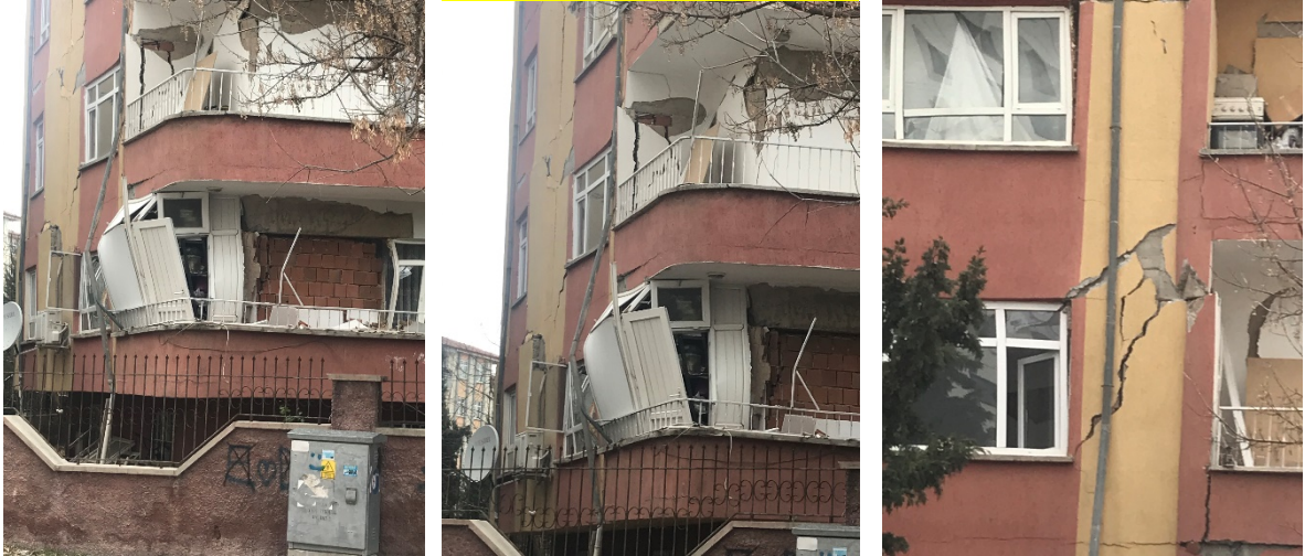
Şekil 4.11. Elazığ-Merkez, ağır kapalı çıkma ve yanlış taşıyıcı sistem seçimi sonrası ağır hasar
