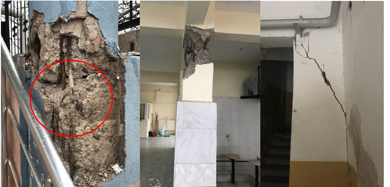
Şekil 4.8. Etriyeyle bağlı yapı hasarları
