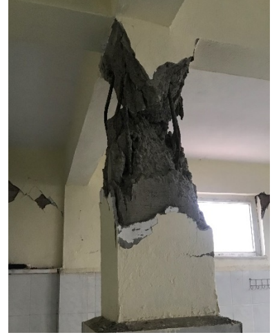
f) Etriyersiz kolon ve oluşan hasar
