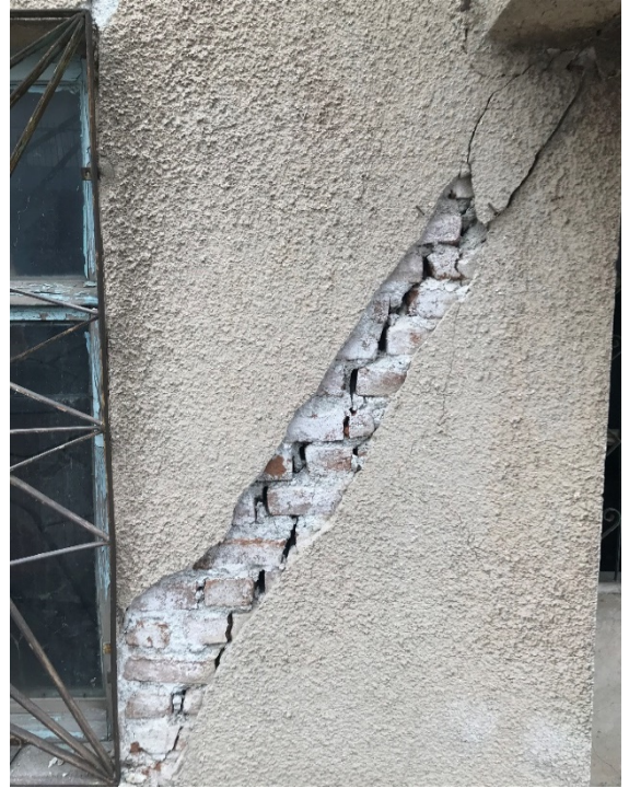
c) Yığma duvar kesme çatlağı
