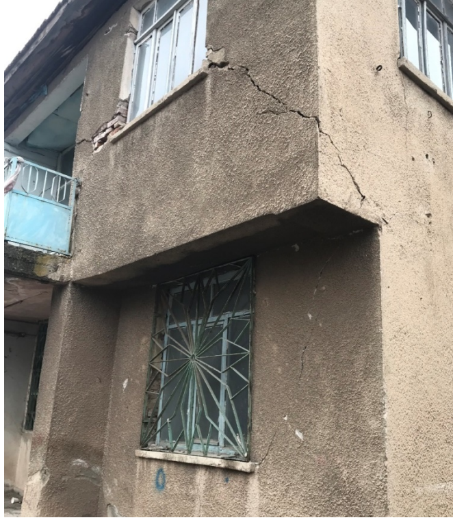
a) Çıkmadan kaynaklı oturma hasarları
