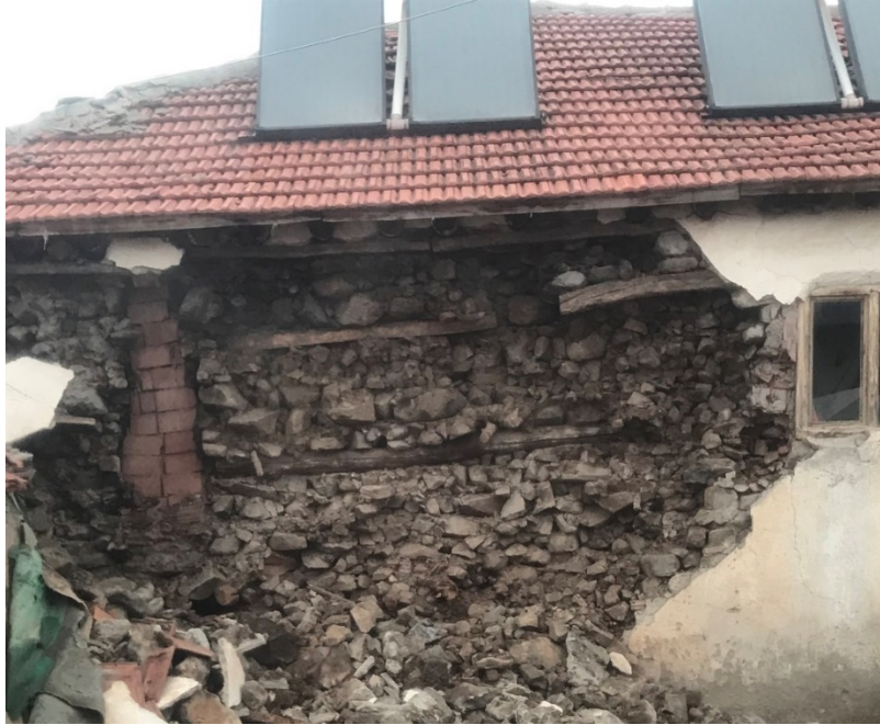
Şekil 5. 1. Duvarların aynı düzlemde bir bölümü yıkılan ağır hasarlı taş duvarlı yığma yapı örneği
