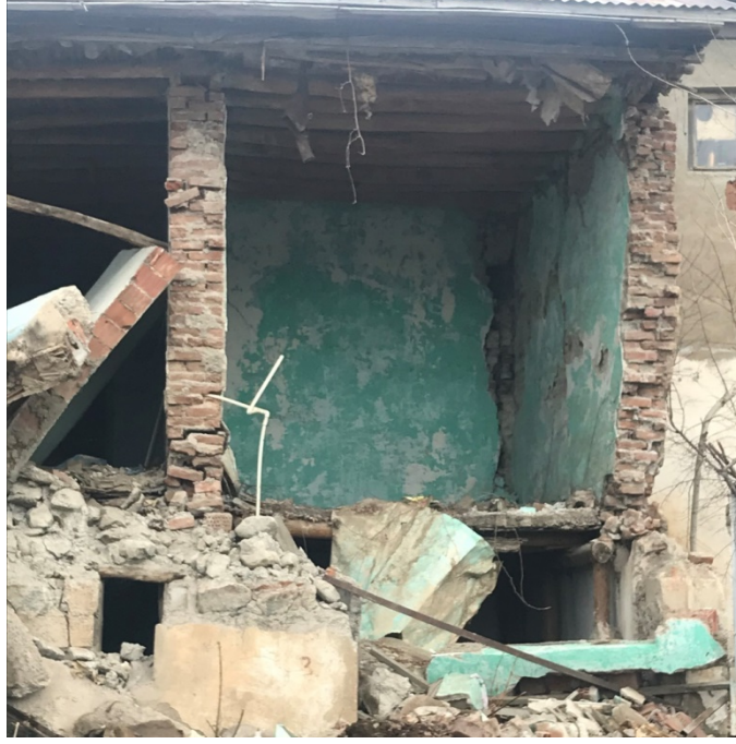
Şekil 5.7. Yığma Tuğla ve harman tuğlalarla inşa edilen bir yapı enkazı
