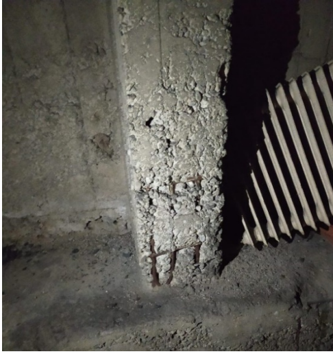
c) Kolonda iyi yerleşmemiş beton
