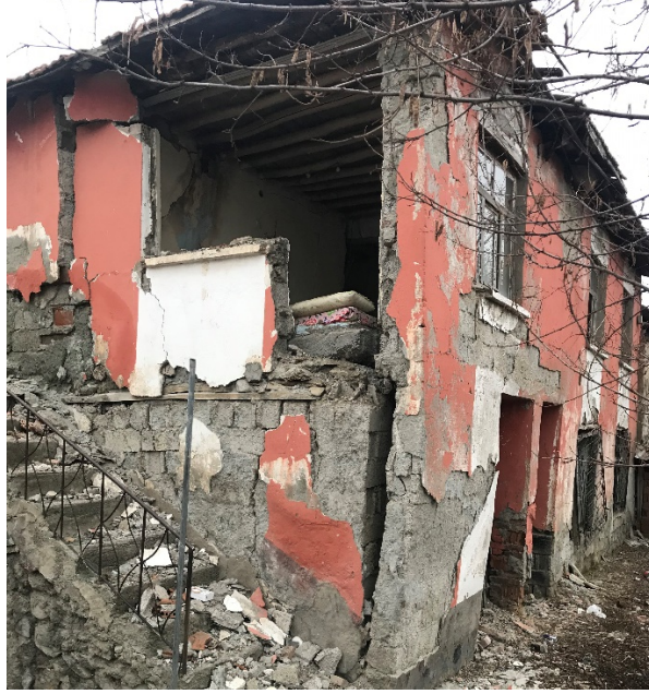
Şekil 5.9. Briket ile inşa edilen yığma yapı hasarı
